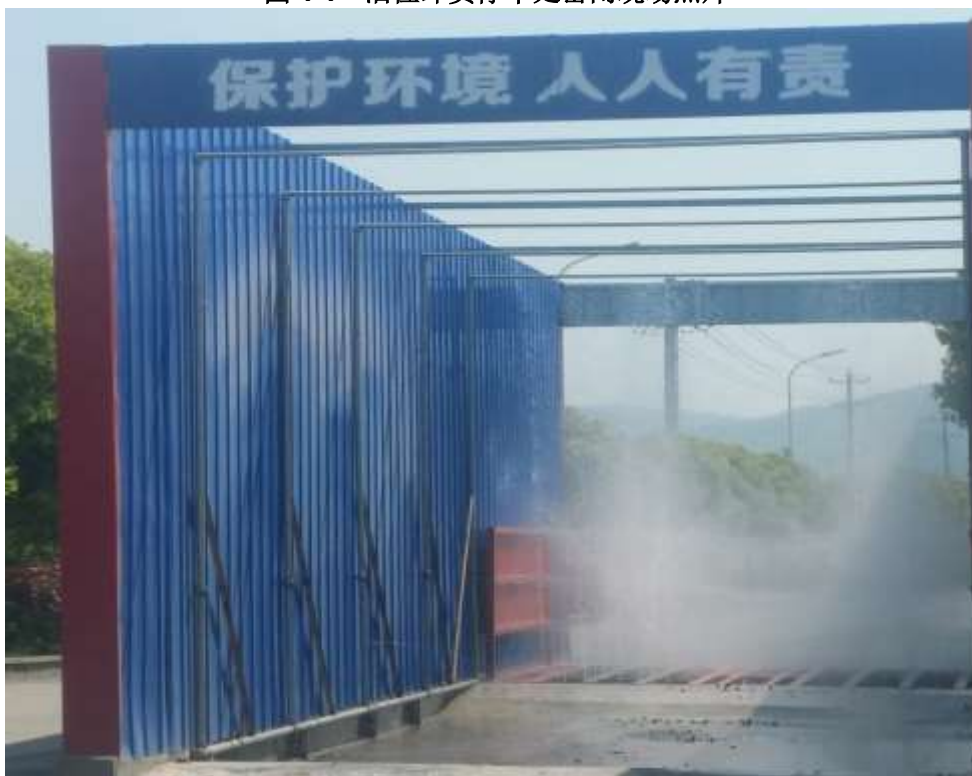
图 4-5 驶出码头运输车辆清洗装置现场图
