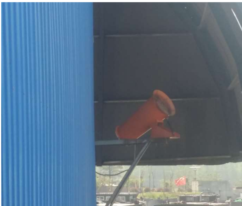
图 4-3 泊位卸货增装喷雾炮现场照片
