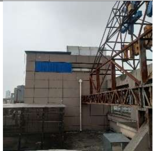
油烟净化器机房
