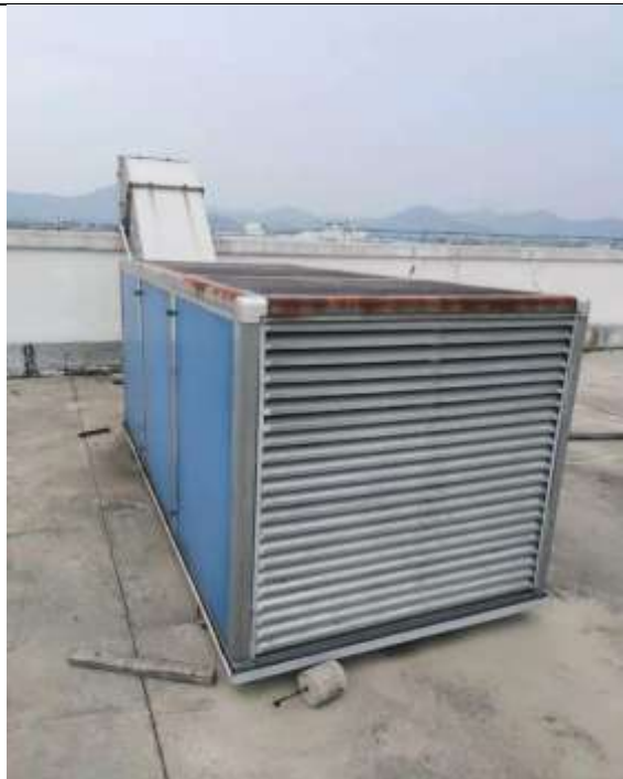
废气处理设备
